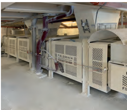
Kastenbeschicker in einem Kalkwerk
