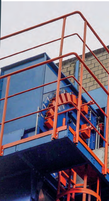
Umlenkung an einem Wellkantenförderer
